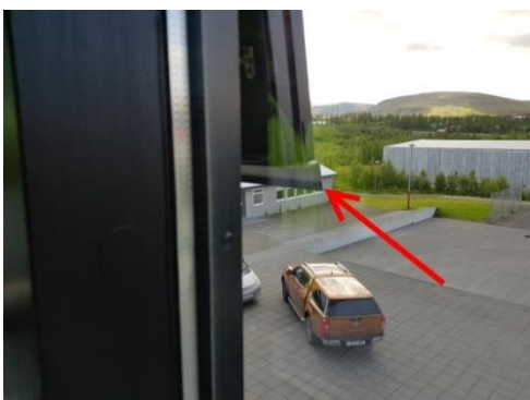
Greinilegt er að mikið hefur lekið inn með opnanlegum fögum en víða er búið að setja flasningu á fög til að reyna hindra leka. Það virðist ekki hafa skilað árangri.
