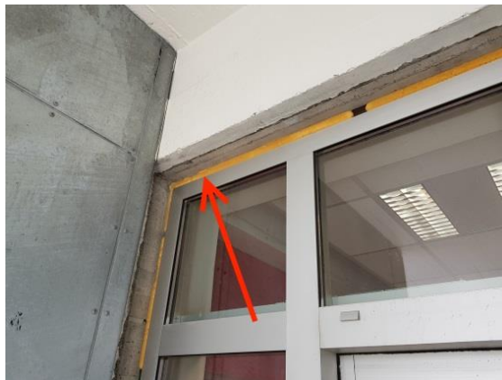
Hér sést slæmur frágangur á álhurð á austurhlið. Hér hefur ekki verið klárað að ganga frá.
