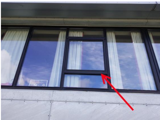
Greinilegt er að mikið hefur lekið inn með opnanlegum fögum en víða er búið að setja flasningu á fög til að reyna að hindra leka. Það virðist ekki hafa skilað árangri.
