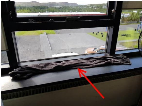
Greinilegt er að mikið hefur lekið með gluggum á austurhlið. Hér hefur handklæði verið sett til að hindra að vatn leki niður á gólf.
