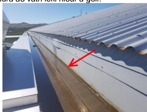
Töluverður pollur hefur myndast í þakrennu á austurhlið þaksins.
