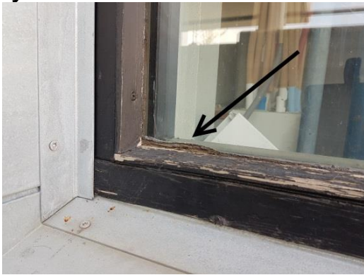
Gluggalistar þéttir með kítti. Lagt er til að skipt verði út glerlistum fyrir nýja glerlista með rauf fyrir EMDB borða .
