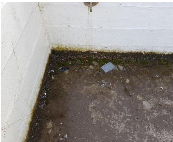
Stigapallur á austurhlið er orðinn töluvert veðraður og komnar í hann frostskemmdir.
