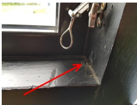
Greinilegt er að mikið hefur lekið inn með opnanlegum fögum en hér má sjá að reynt hefur verið að þétta með því að dæla þéttiefni í samskeyti pósta.
