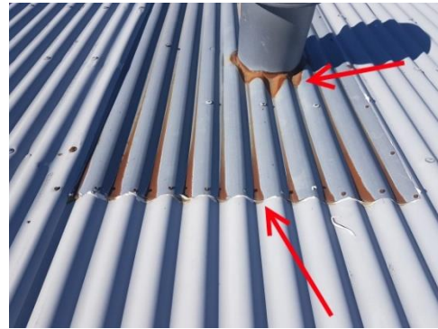
Ryð í kringum lofttúðu og í plötu sem lofttúða er soðin í. Búið er að kítta í kringum plötu þar sem frágangur á plötunni er lélegur.
