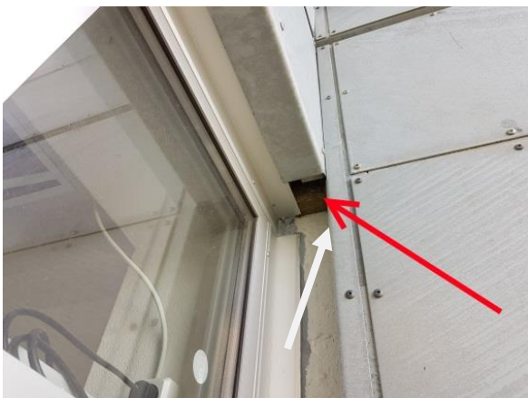
Slæmur frágangur við álhurð á vesturhlið en hér sést upp í einangrun.
