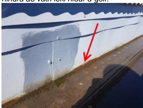
Hér sést ryð í þakrennu.
