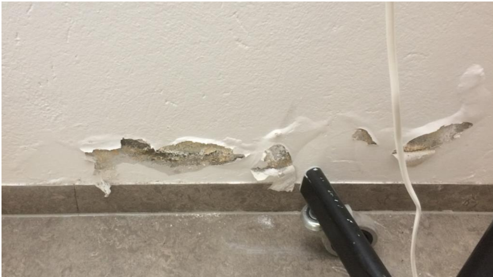
Mynd 1. Sveppaútfelling í vegg eldri deild Varmárskóla
