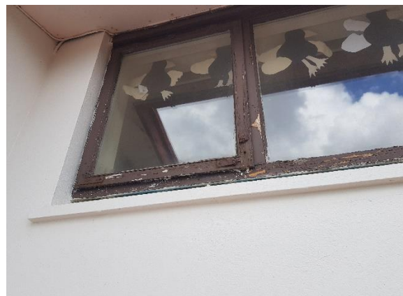
Illá farinn gluggi á norðurhlíð vesturálmú. Lagt er til að glugginn verði endurnýjaður.
