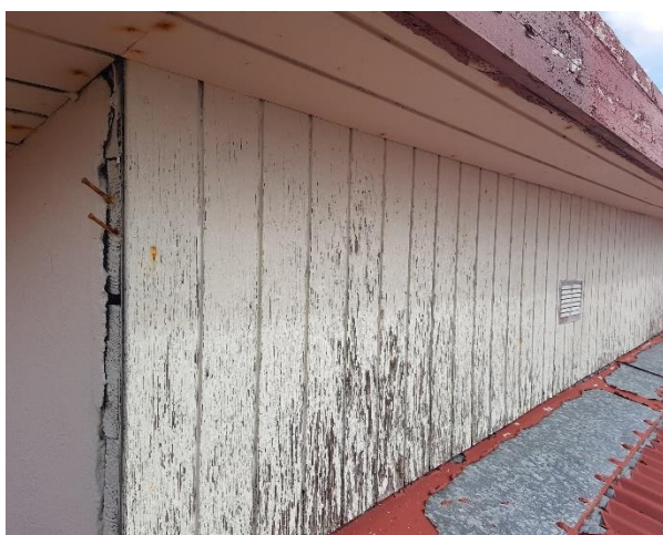
Frágangur við stallað þak með rásuðum krossviði. Hér er lagt til að klæðning við stallað þak verði endurnýjuð og að notast við við slétta álklæðningu.
