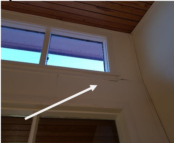
Hér sjást ummerki eftir leka að inna frá glugga við stallað þak.
