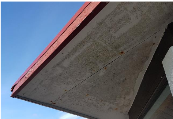
Hér má sjá undir þakkant en mikið er um ryð og illa farna klæðningu undir þakköntum.
