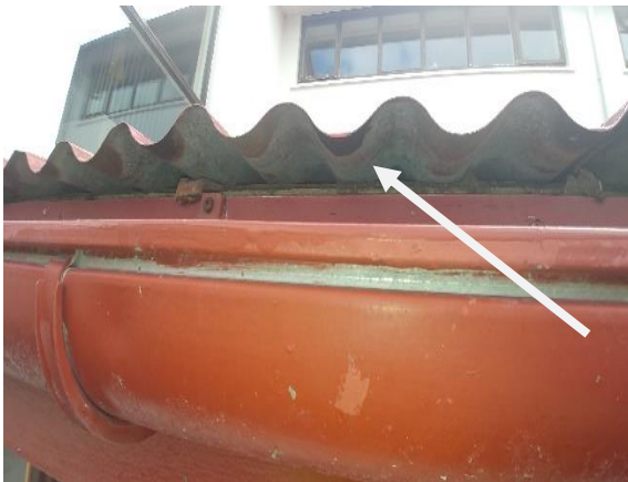
Ryð undir þakjárnri sem er ekki hægt að lagfæra.
