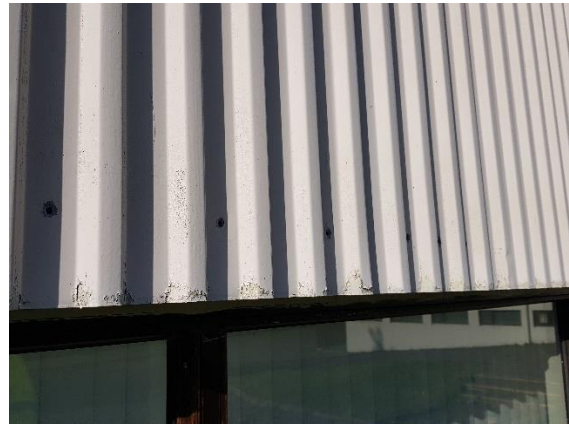
Klæðning á suðurhlíð vesturálmur er víða laus og þarfnast viðgerða og endurmálunar.
