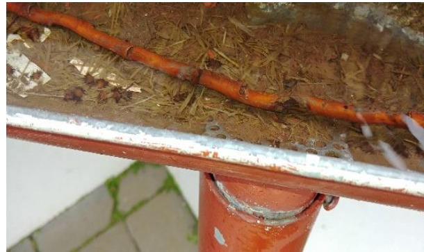
Stíflaðar þakrennur voru nokkuð algeng sjón við skoðun á þaki.
