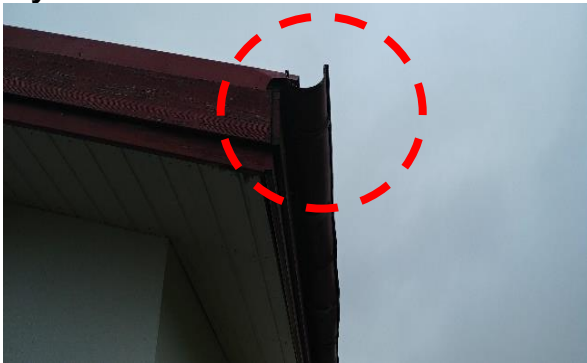
Vantar lok á enda þakrennu. Þetta sást víða á þakrennum, en hér getur vatn runnið niður á það sem fyrir neðan er.
