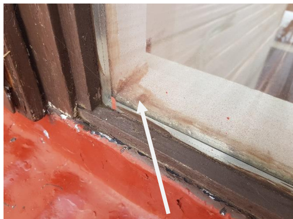
Hér sést leki að innanverðu í glugga við stallað þak.
