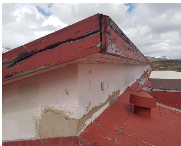
Töluverðar múrskemmdir við stallað þak. Hér er lagt til að veggflötur við stallað þak verði klæddur með sléttri álklæðningu.
